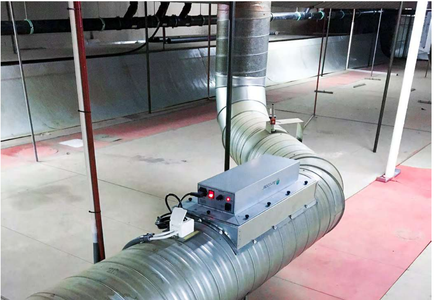
Idac-500 installerad på tilluftskanalen.
